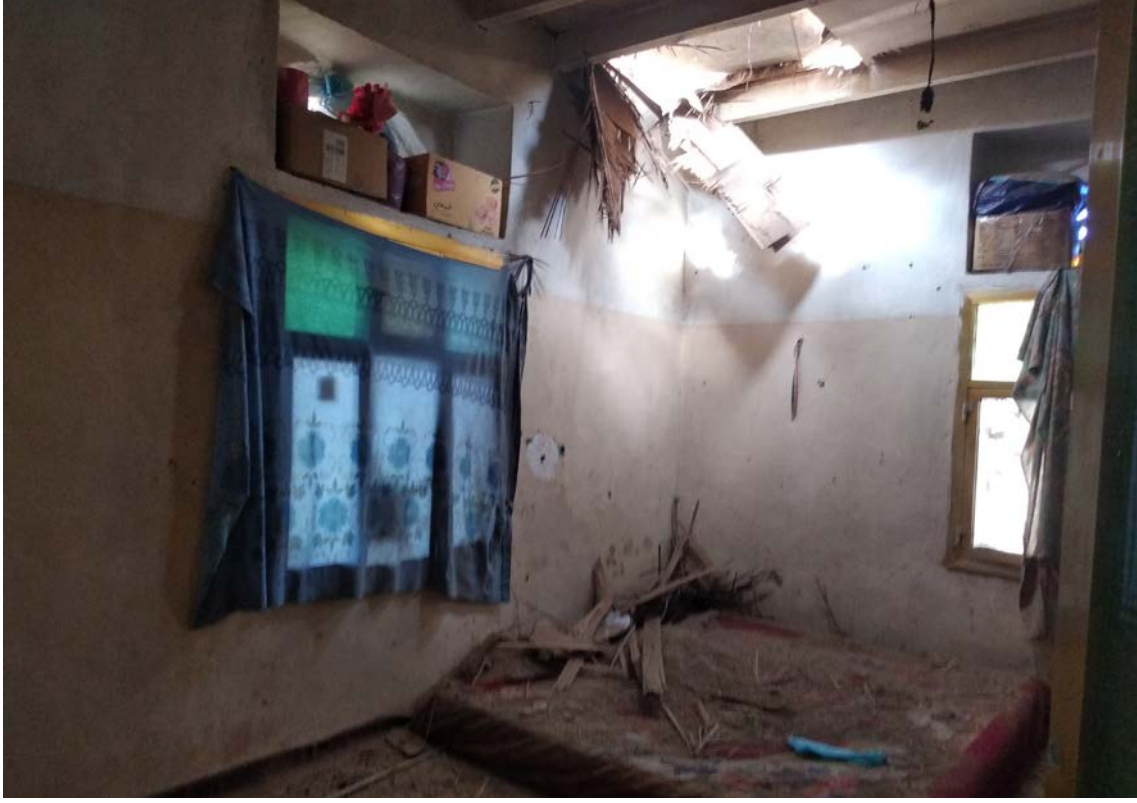
غرفة متضررة في منزل في منطقة بير باشا، حي المطار القديم، مديرية المظفر، محافظة تعز، تم التقاط الصورة بتاريخ 16 نوفمبر/ تشرين الثاني 2020. © مواطنة.
